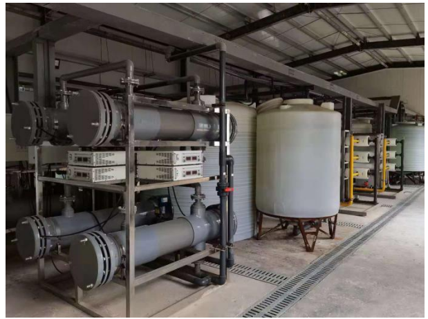
膜处理设施及产水罐
